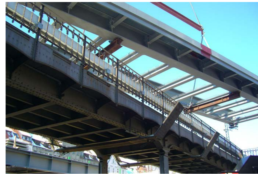
Die neue Stahlbrücke schwebt über die alte Stahlbrücke – hier bei der Montage der dritten Eisenbahnüberführung im März 2013 am S-Bahnhof Stötteritz. Die untere Brücke wurde später demontiert.
